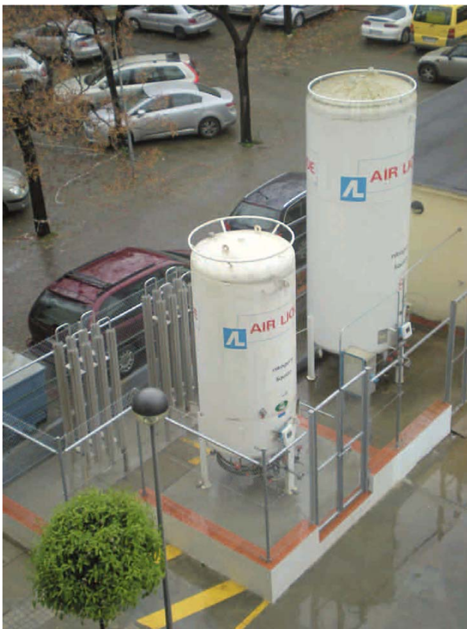
Figura 37: Tanques exteriores de Nitrógeno de 3.000 y 7.000 L.
